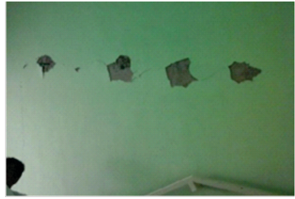
b) Plester jatuh pada dinding bangunan Rumah Sakit Kristen Lende Moripa, Waikabubak
