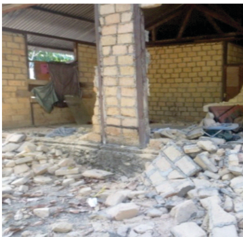
c) Kerusakan rumah di kampung Makbon, Distrik Makbon
