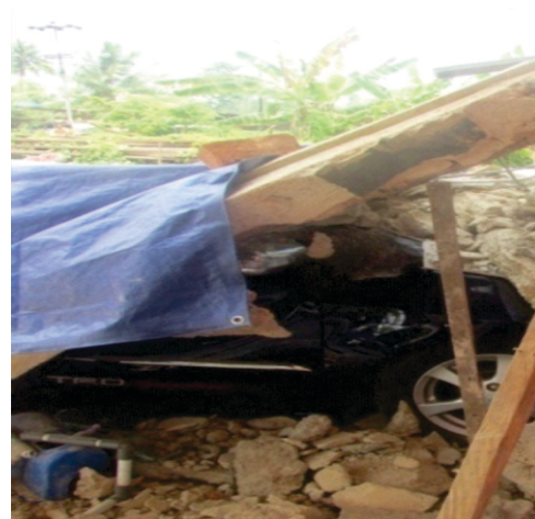
d) Kerusakan bangunan di kelurahan Malawili, Distrik Aimas
