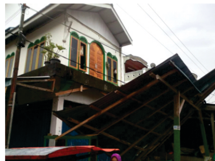
d) Atap jatuh pada bangunan rumah penduduk
