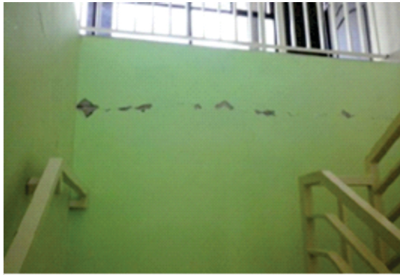
a) Retak ringan pada dinding bangunan Rumah Sakit Kristen Lende Moripa, Waikabubak
