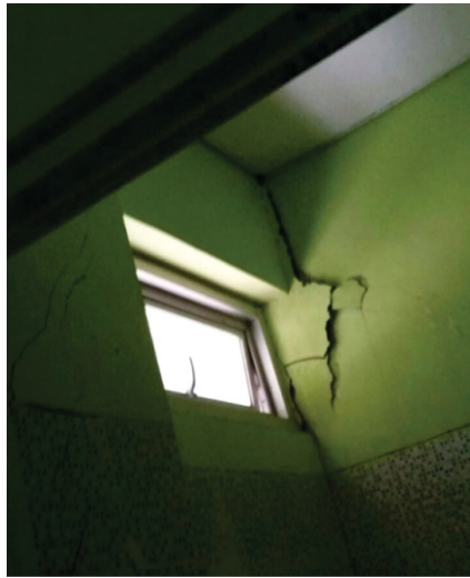
a) Retak pada dinding bangunan rumah penduduk.
