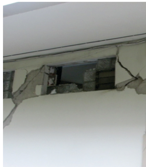
f) Kerusakan Bangunan Hotel Meridien, kota Sorong
