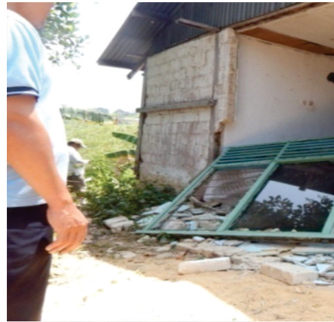
b) Kerusakan rumah di kelurahan Puncak Cenderawasih, Distrik Sorong Barat
