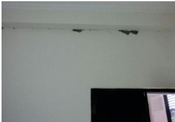
c) Retak ringan pada sudut bangunan Rumah Sakit Umum di Waikabubak
