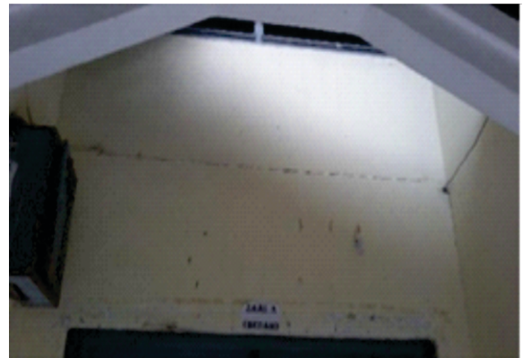
d) Retak ringan pada dinding bangunan Rumah Sakit Umum di Waikabubak
