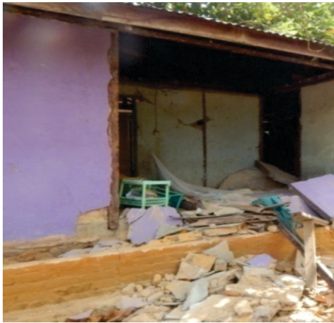
a) Kerusakan rumah di kelurahan Puncak Cenderawasih, Distrik Sorong Barat.
