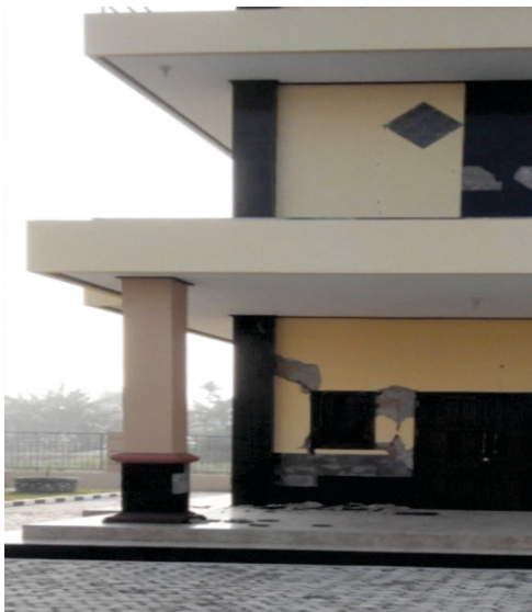
e) Kerusakan Bangunan Radar di Stasiun Meteorologi BMKG Sorong
