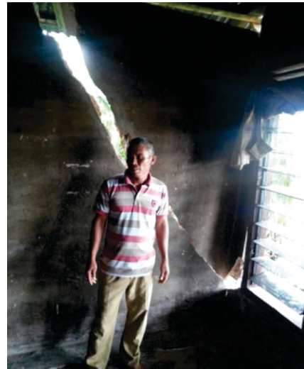
b) Kerusakan sedang pada bangunan rumah penduduk.
