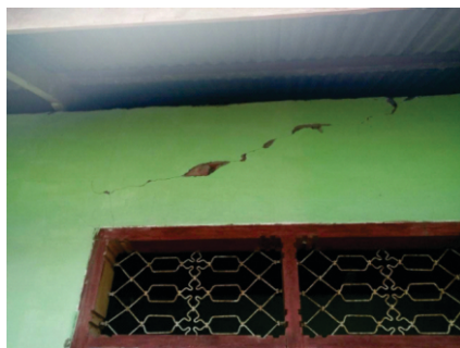
c) Retak ringan pada dinding bangunan rumah penduduk.
